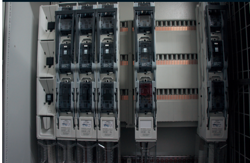
Durch das neue 185mm 1600 A / 2b konnten Einspeiseadapter sowie Lastschaltleisten schnell verbaut werden.
