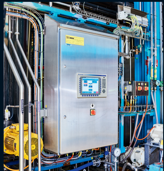
Im Nestlé-PTC in Orbe sind gleich mehrere Rittal-Schaltschränke, Bediengehäuse und Klemmkästen installiert.
