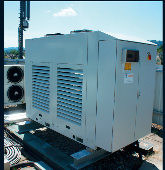
Ein Chiller am Dach des Gebäudes unterstützt die Arbeit der LCPs. Sicherheitsrelevante Merkmale: redundante drehzahlgeregelte Pumpen, Kompressoren oder Pufferspeicher.
