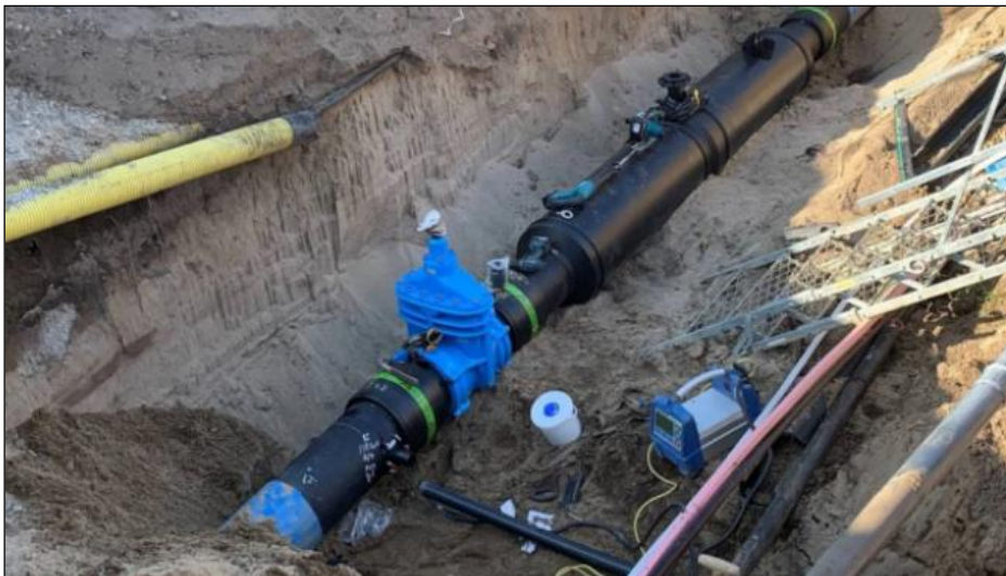
Bilde 4.2: PE rør med armatur.
